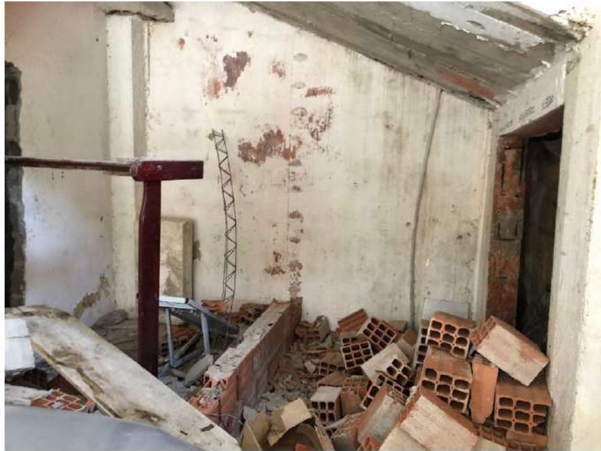
FOTO 51 – DETALHE DO ENTULHO NA GARAGEM DO PAVIMENTO INFERIOR
