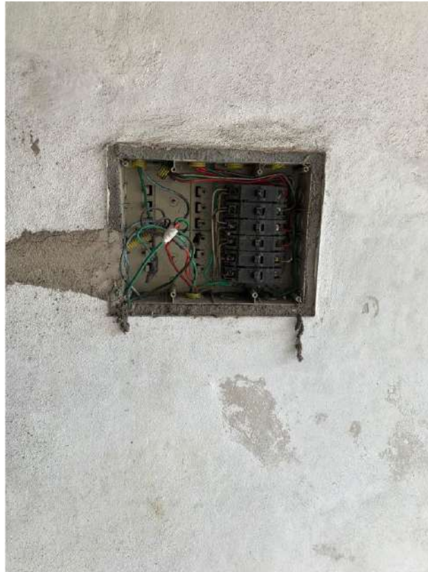
FOTO 07 – QUADRO DE DISTRIBUIÇÃO DE ENERGIA
