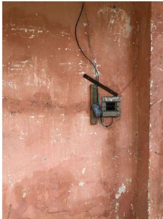
FOTO 42 – QUADRO DE DISTRIBUIÇÃO DO PAVIMENTO INFERIOR
