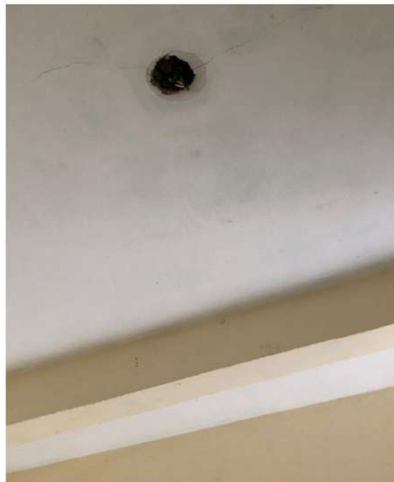
FOTO 10 – PONTO DE ILUMINAÇÃO SEM ACESSÓRIOS
