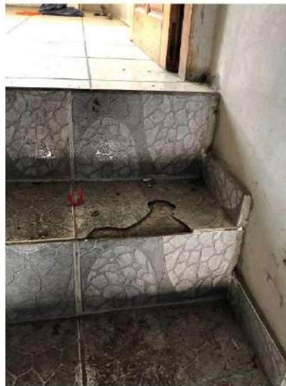
FOTO 18 – DETALHE DA AVARIA DO REVESTIMENTO DA ESCADA DE ACESSO AO PAVIMENTO SUPERIOR
