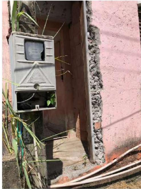
FOTO 35 – PADRÃO DE ENTRADA DE ENERGIA DO PAVIMENTO INFERIOR PELA RUA TEODORO FERREIRA MACHADO
