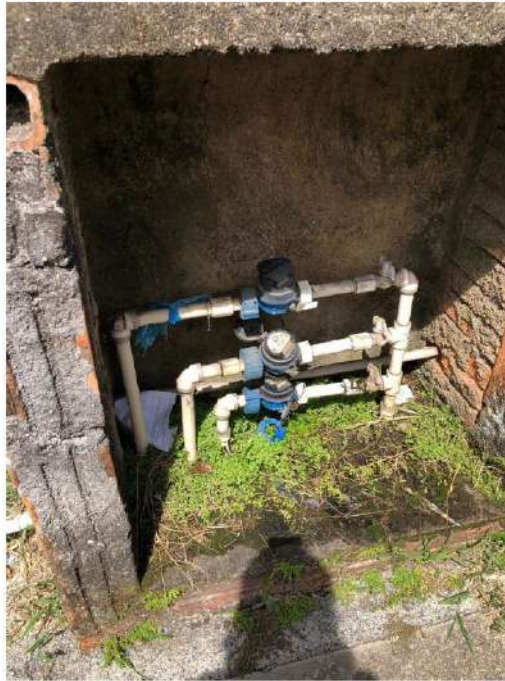
FOTO 41 – CONJUNTO DE HIDRÔMETROS DE ABASTECIMENTO DE ÁGUA DA EDIFICAÇÃO
