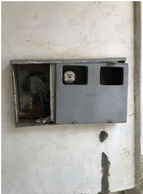
FOTO 05 – PADRÃO DE ENTRADA DE ENERGIA
