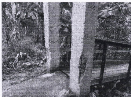
a) Pilarete danificado.
