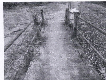
d) Pavimentação danificada.
