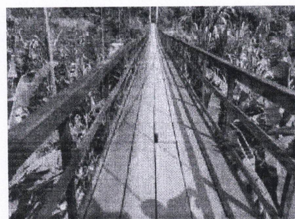
c) Assoalho danificado.
