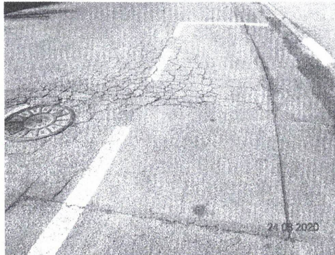
Foto 04 – Trinca couro de Jacaré – estão associadas à repetição das cargas de tráfego (concentram-se nas trilhas da roda)
