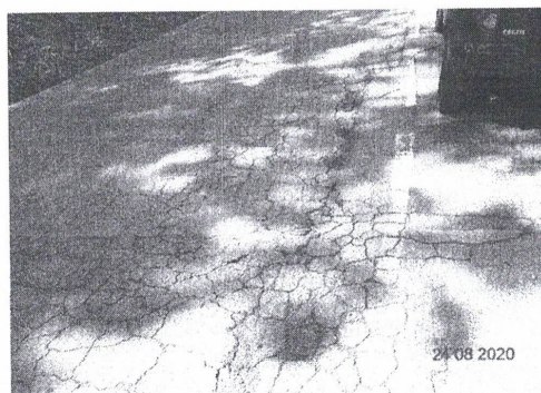
Foto 03 – Trinca couro de Jacaré – estão associadas à repetição das cargas de tráfego (concentram-se nas trilhas da roda)
