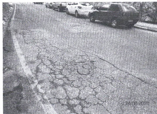
Foto 09 – Trinca couro de Jacaré – estão associadas à repetição das cargas de tráfego (concentram-se nas trilhas da roda)
