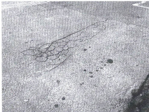
Foto01 – Trinca couro de Jacaré – estão associadas à repetição das cargas de tráfego (concentram-se nas trilhas da roda)
