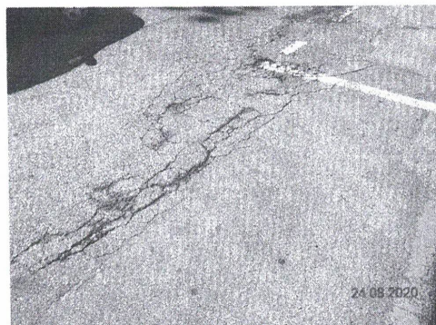
Foto 02 – Trinca couro de Jacaré – estão associadas à repetição das cargas de tráfego (concentram-se nas trilhas da roda)
