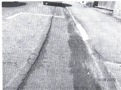
Foto 05 – Remendo: panela preenchida com uma ou mais camadas de pavimento na operação denominada "Tapa Buraco"
