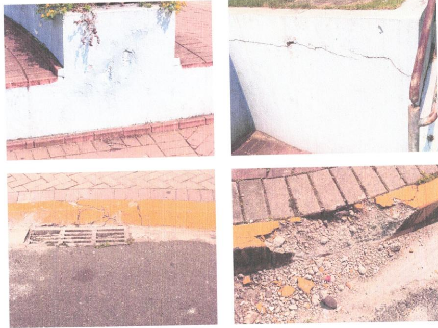
Figura 1: Trincas em áreas diversas da Praça da Bíblia.
