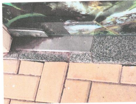
Figura 2: Soleira da entrada do Inclusão Digital quebrada.
