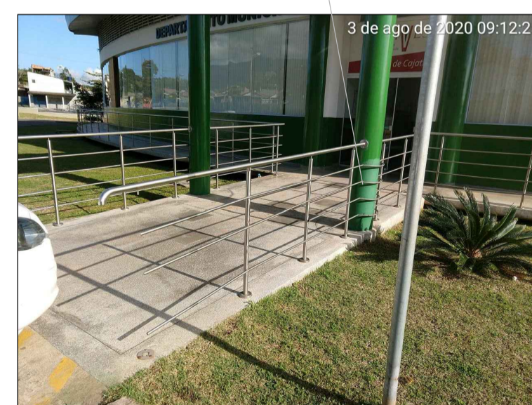
DETALHE 1 - AUSÊNCIA DE MONTANTE
